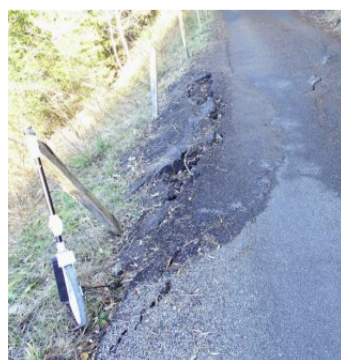
Der Abschnitt Blatten bis Älgi der Älggistrasse weist zahlreiche Schäden auf. Bild: Korporation Sachsln/zvg
